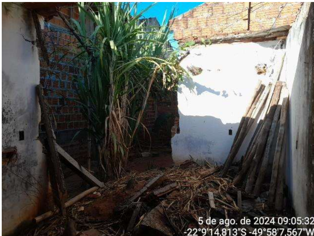
18. Vista interna do imóvel, com alvenarias e lajes danificadas.
