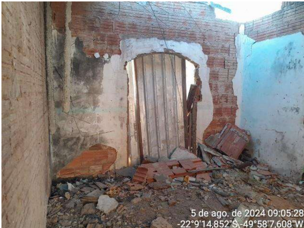
17. Vista da sala, com alvenarias e estrutura em avançado estado de degradação.
