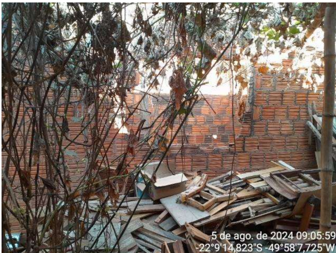
21. Condições de degradação do imóvel avaliando.
