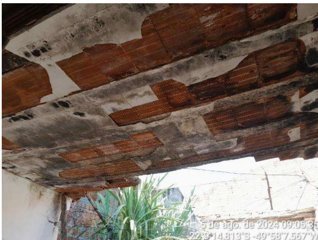
19. Laje danificada e com risco de desmoronamento.
