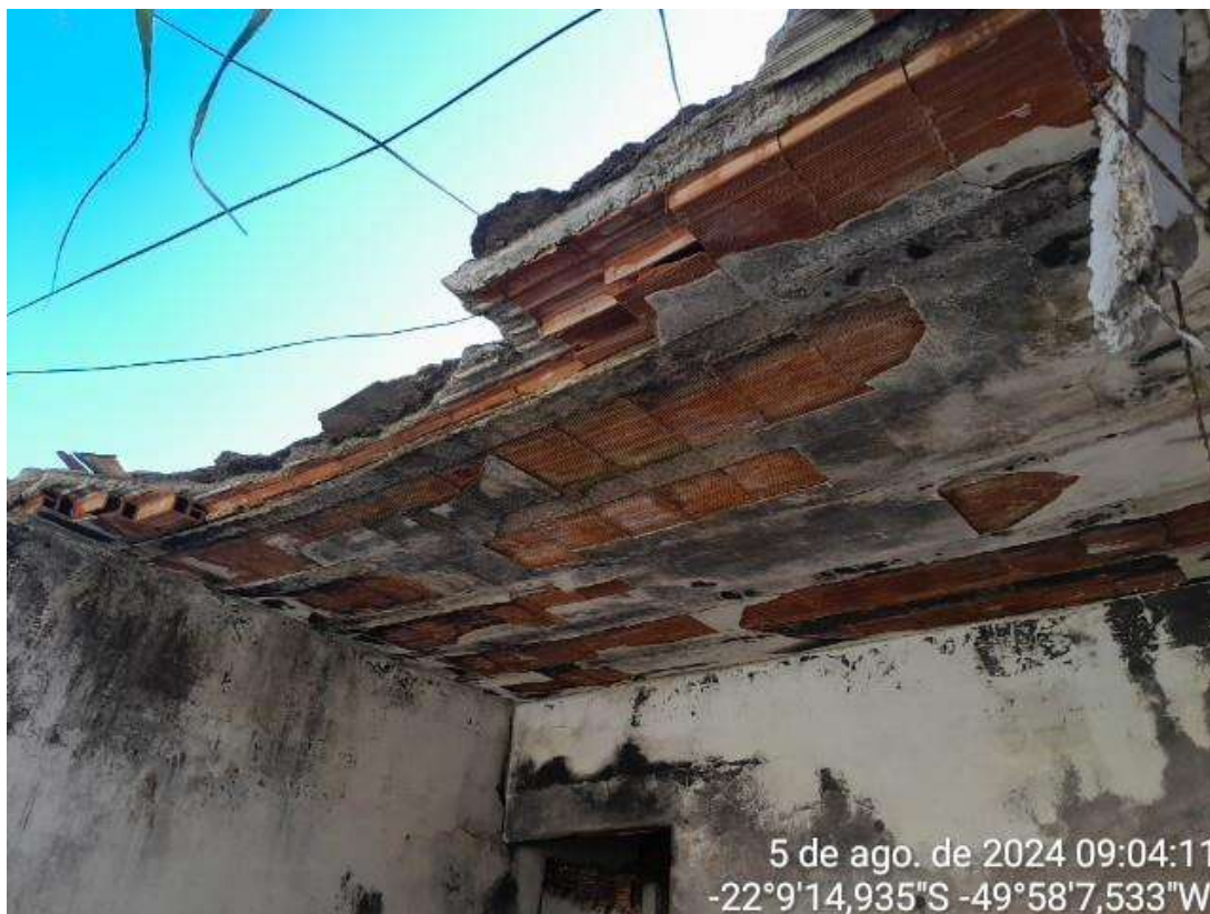
11. Laje danificada e com risco de desmoronamento.
