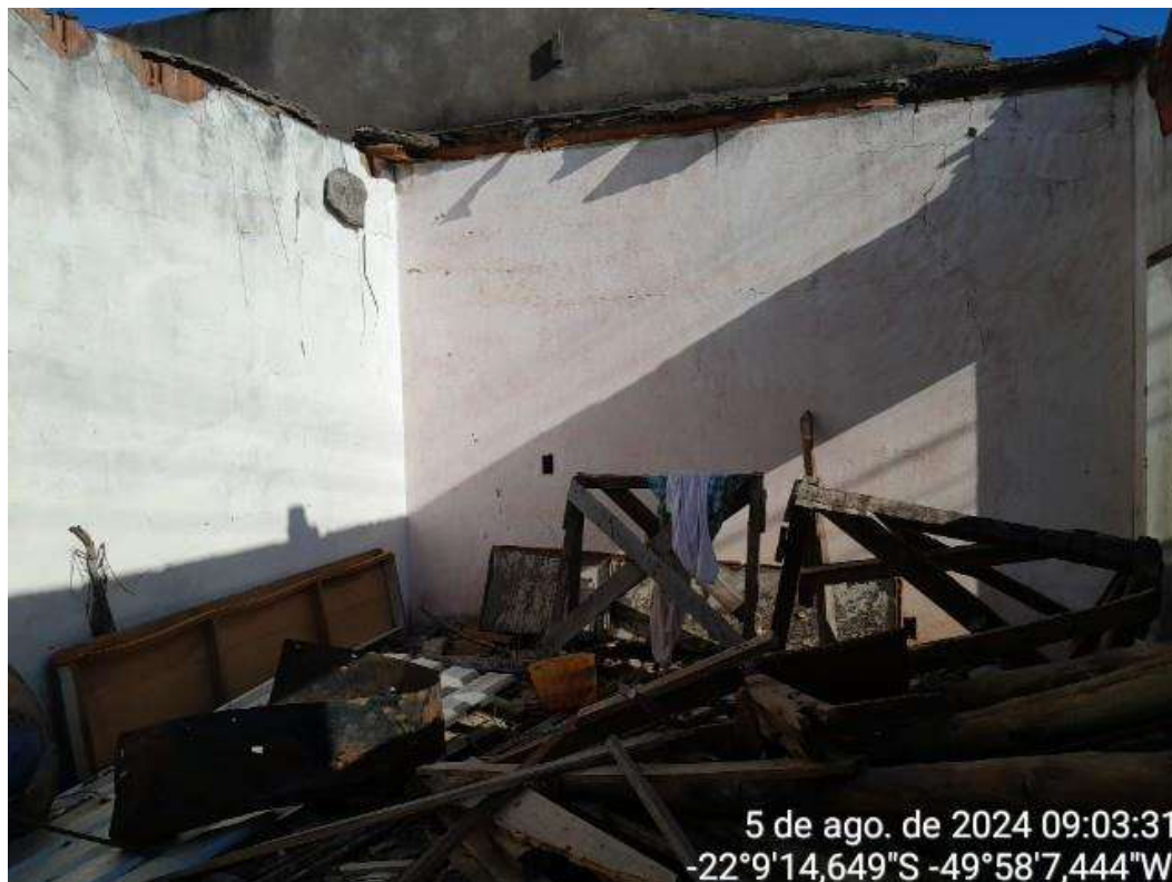
8. Vista interna do imóvel, com entulhos de obras, móveis, dentre outros objetos.
