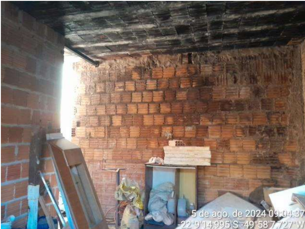
14. Vista interna do imóvel, em avançado estado de degradação e sem condições de habitabilidade e recuperação.
