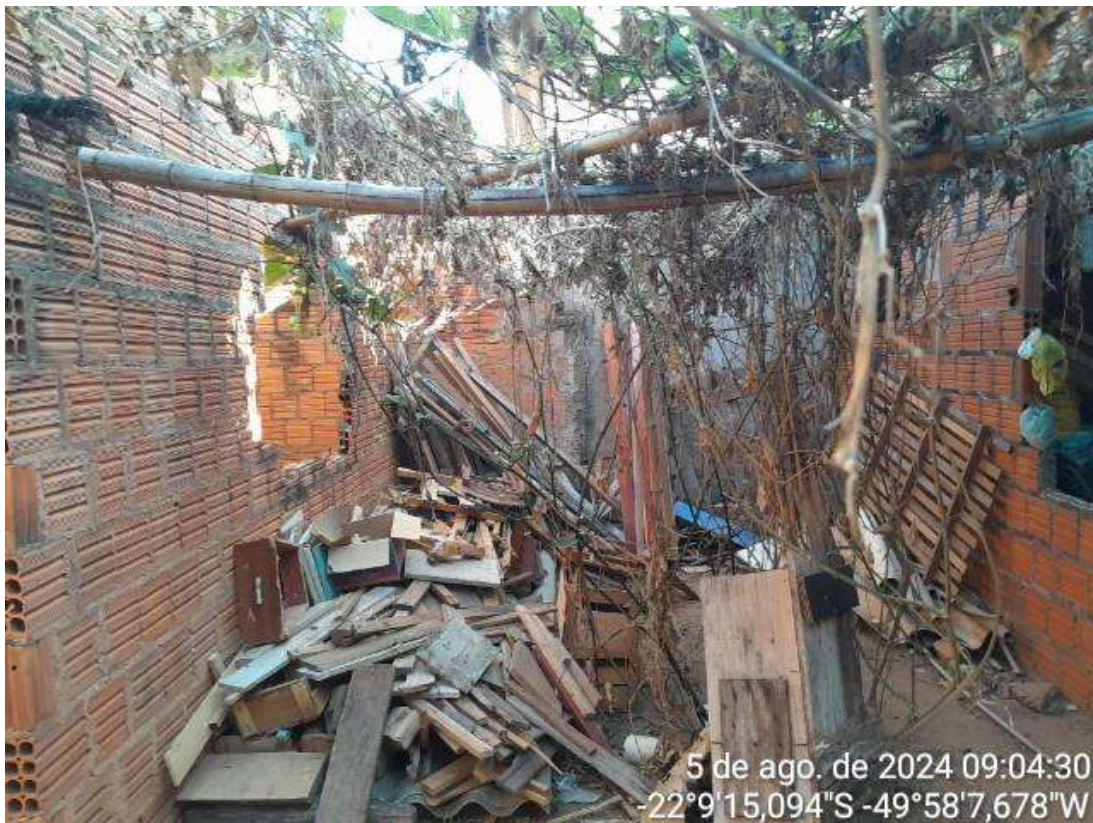
13. Vista dos fundos do imóvel, com vegetação e paredes danificadas.
