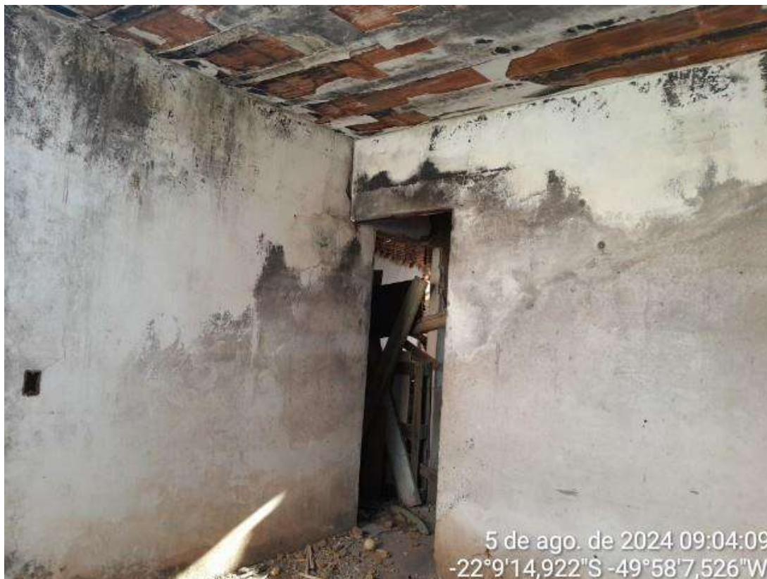
10. Vista interna do imóvel, com avançado estado de degradação.
