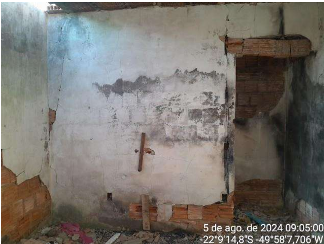
15. Vista interna do imóvel, em avançado estado de degradação e sem condições de habitabilidade e recuperação.
