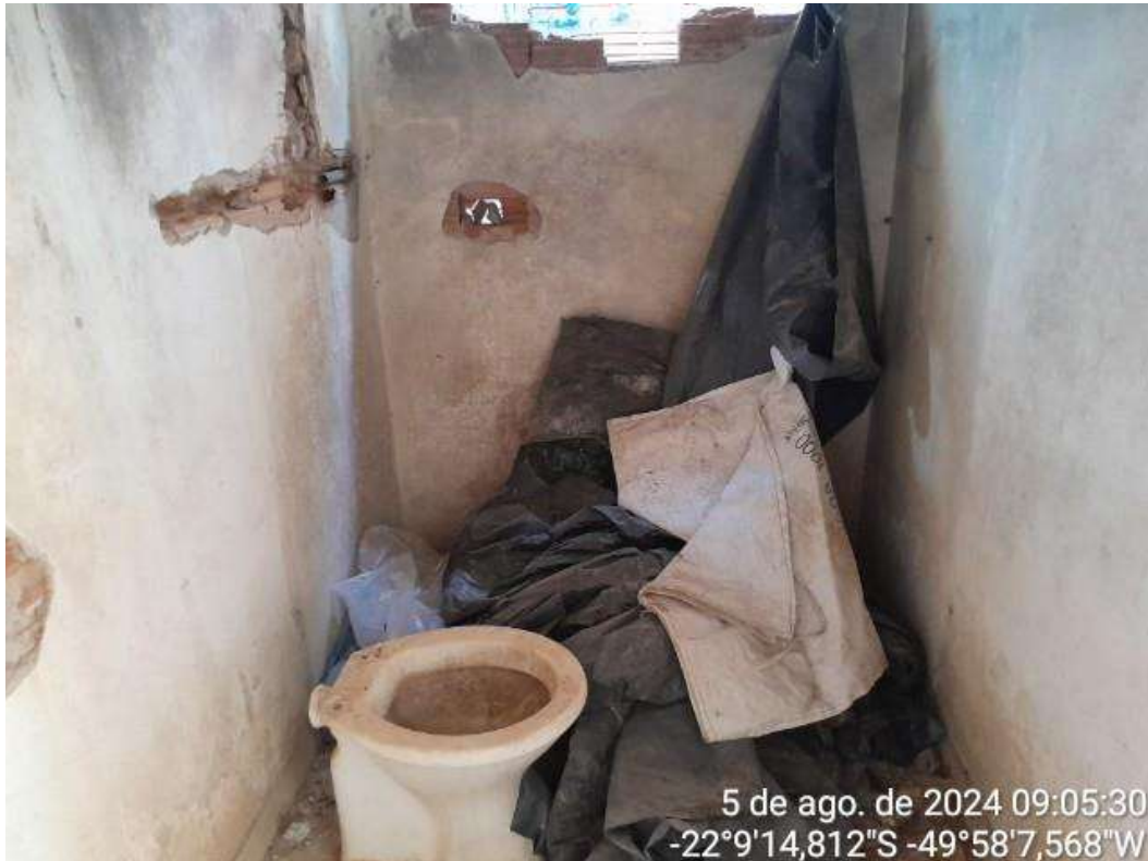
16. Vista do banheiro social, danificado e sem condições de uso.
