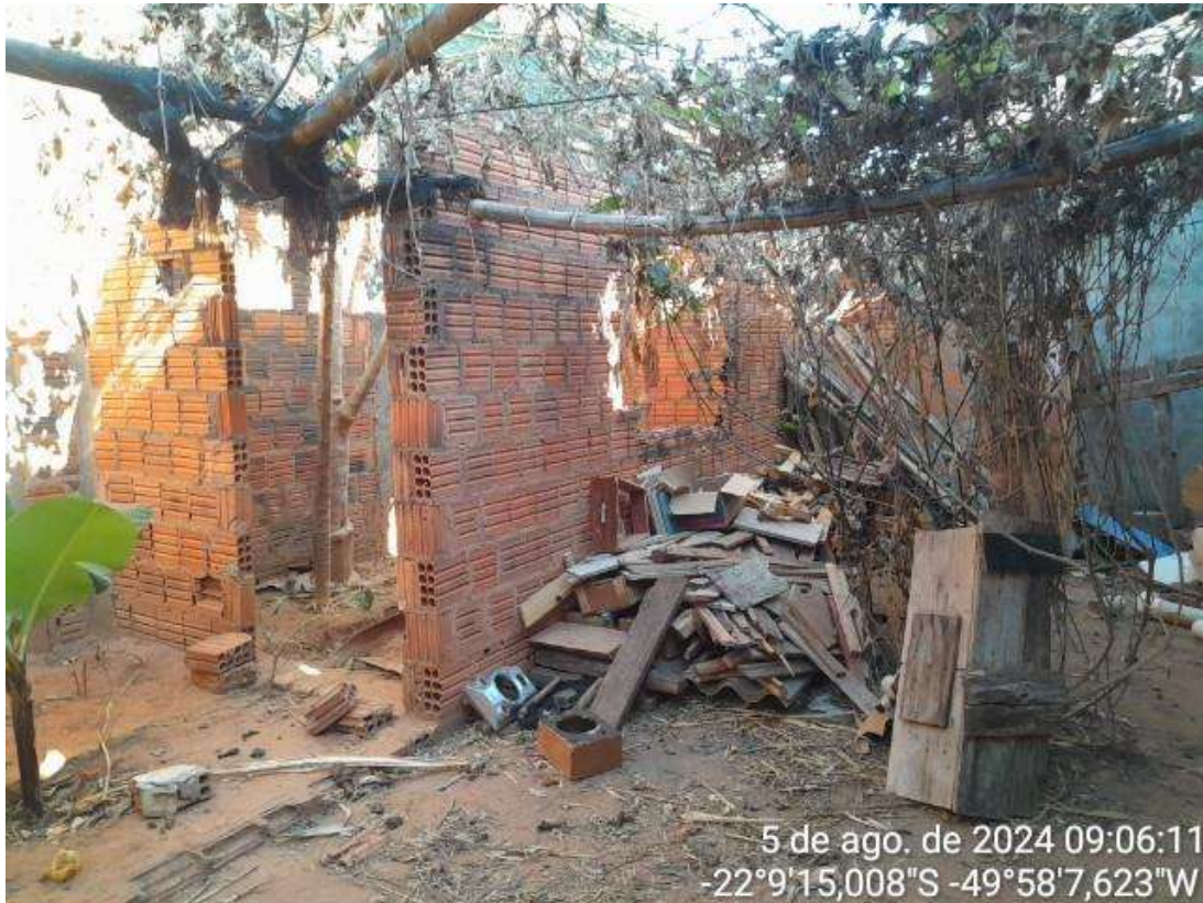
20. Condições de degradação do imóvel avaliando.
